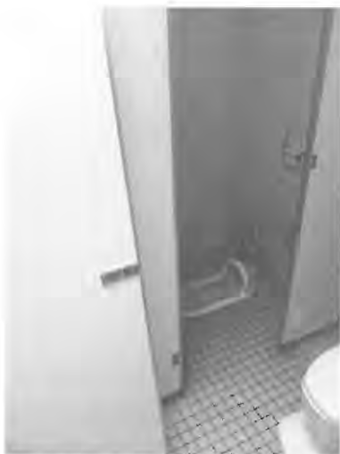
写真1 避難所体育館の和式 トイレ
